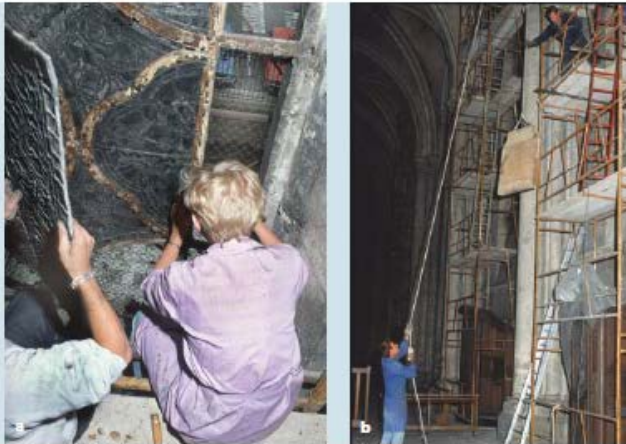
Chartres (28), cathédrale, a. Baie n° 42, dépose de panneaux par l'extérieur (©. LRMH). b. Transport de panneaux pour descente au sol dans un caisson vertical (©. LRMH).
